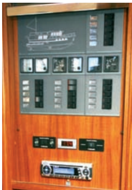
Elektrik vom Feinsten.
